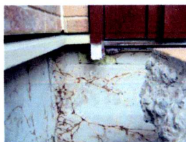
玄関の被害、断熱材撤去後の蟻道痕
