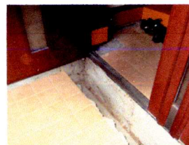
玄関部分の被害 断熱材撤去後の蟻道痕と家屋への侵入被害状況
